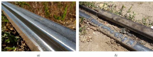
Рис. 1 Дефекты колеи в эксплуатации: а – увеличение ширины колеи в кривом участке, б – некорректный стык рельс
