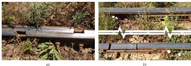
Рис. 2. Дефекты колеи в эксплуатации: а – зазор в стыке рельс, б - положение стыков вне плоскости поперечного сечения колеи
